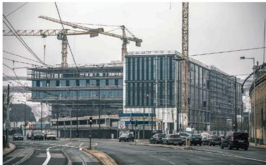
O novo hospital da Cuf Infante Santo, em Alcântara, é uma das grandes obras em que estão a trabalhar FOTO TIAGO MIRANDA
